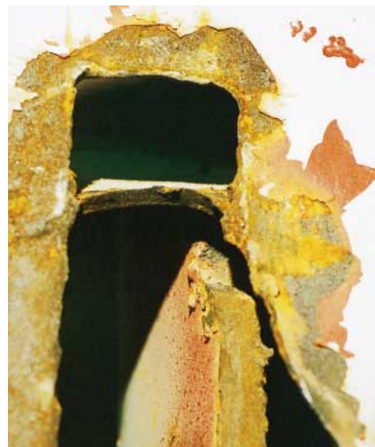
Figur 12.23 Bristning på platsen för styrbords sidolåsöra vid horisontella stringern.
