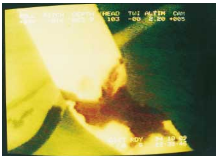
Figur 8.12 Intryckningar på en balk på rampens undersida.
