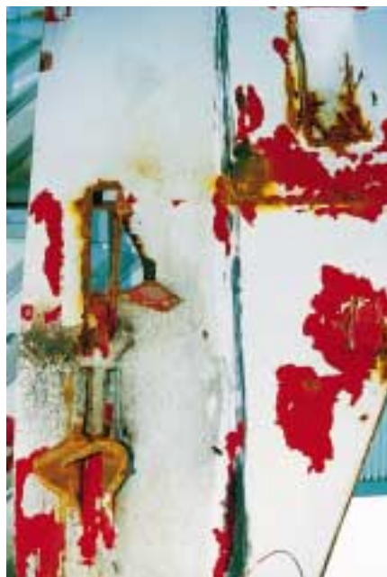
Figur 8.20 Skada på visirets akterskott på styrbordssidan nära det avskilda sidolåsörat.
