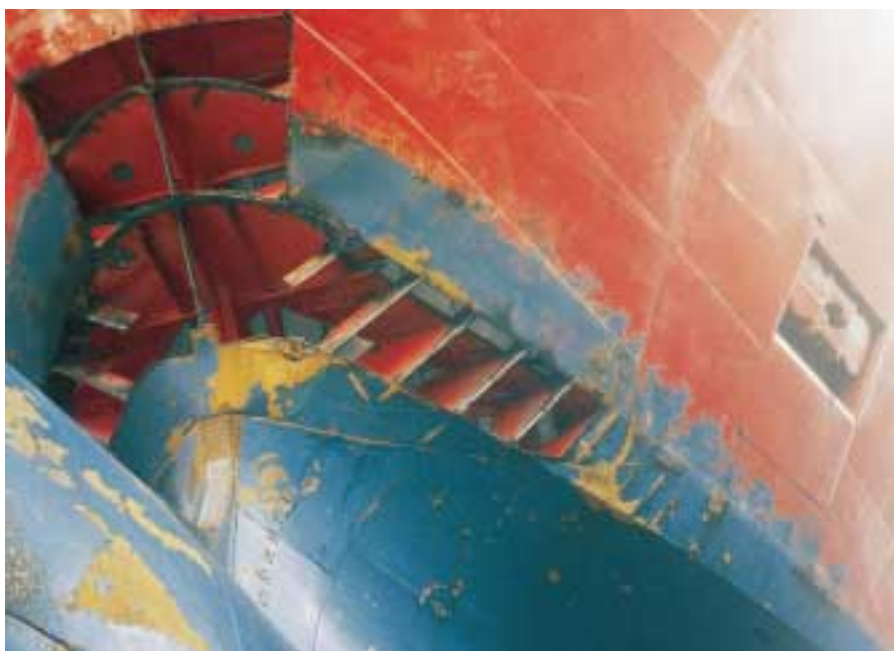
Figur 3.12 Omfattning av reparationer år 1987 efter issskador
